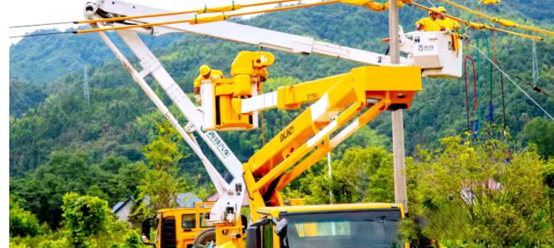
茶产业是东至县山区群众增收致富的重要产业,目前全县超九成茶厂采用电杀青、电理条、电烘干等清洁化设备,建成智能化生产线40多条。为全力保障采茶季电力供应,县供电公司主动靠前服务,新建10千伏专线400米,把变压器容量从50千伏安扩容到400千伏安,茶区用电瓶颈一举破解。图为施工现场。 通讯员 丁满莲 摄
