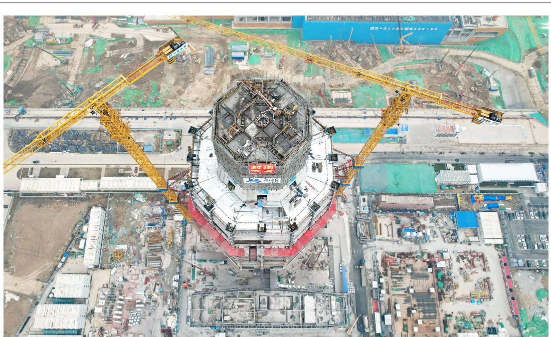
3月27日拍摄的中国中化大厦建设现场(无人机照片)。当日，河北雄安新区启动区标志性建筑之一，中国中化大厦实现核心筒主体结构封顶。中国中化大厦是首批疏解央企中国中化的总部大楼，设计结构高度150米。历经两年建设，这座采用白洋淀“金芦苇”设计理念的大楼初露真容，呈现出层层簇拥、拔节生长的体态。
