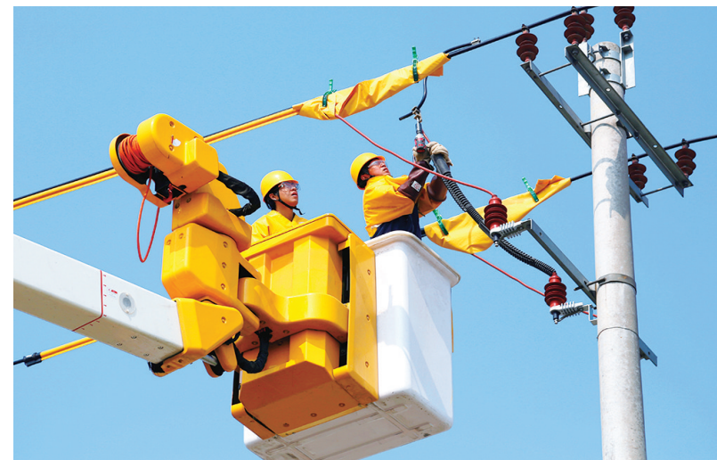
为保障用户安全用电需求,连日来,国网池州市贵池区供电公司紧锣密鼓地开展春季安全生产大检查。图为该公司带电作业人员在10千伏阮桥114线路对避雷器进行更换升级检修。 通讯员 彭永进 摄
