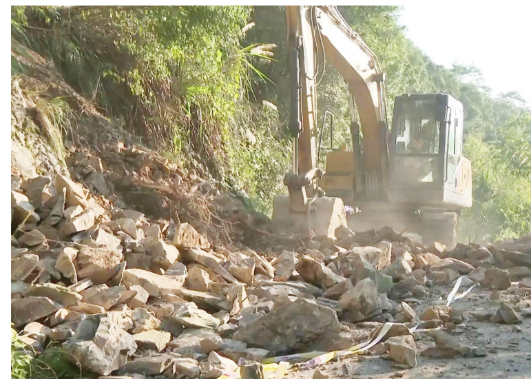
近日,东至县出现持续性强降雨天气,花园乡受灾较为严重。暴雨过后,花园乡第一时间组织开展灾后重建工作。图为施工人员进行山体滑坡路段进行作业。 通讯员 东宣 摄
